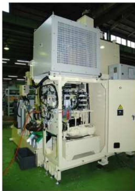
電源トランス—上側と油圧、空圧、潤滑装置
