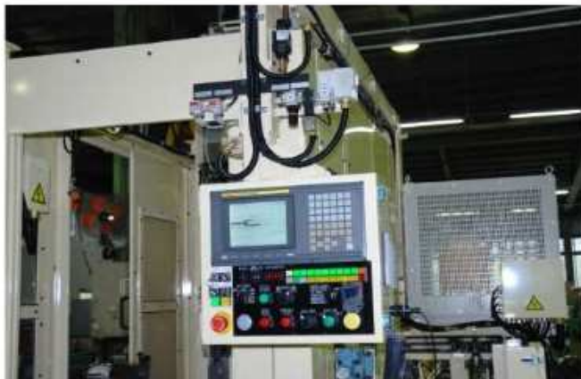
操作盤—機械正面右側に配置
