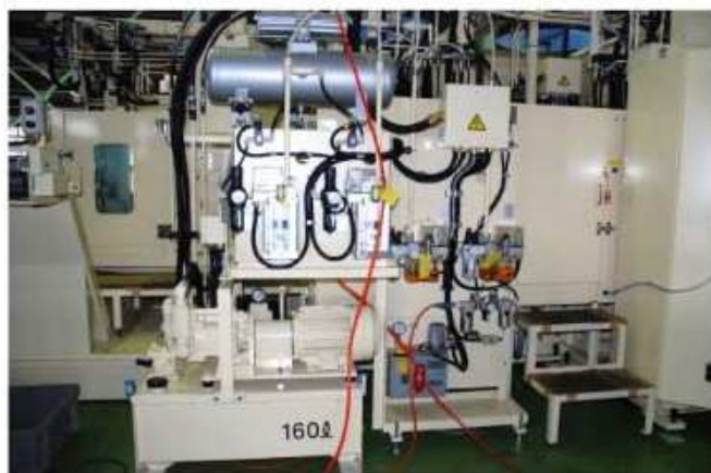
油圧、空圧、潤滑装置
