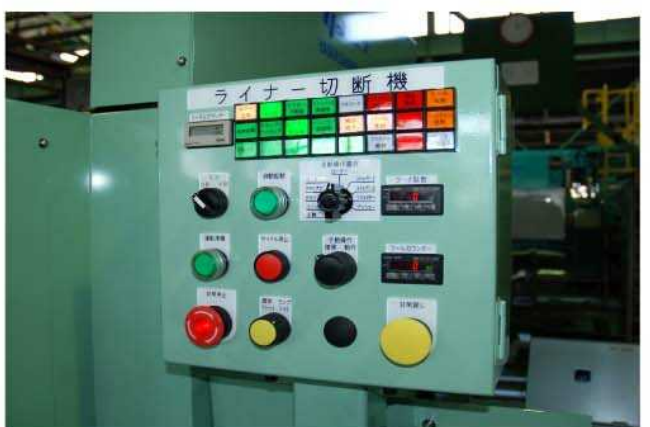
切断機操作盤
