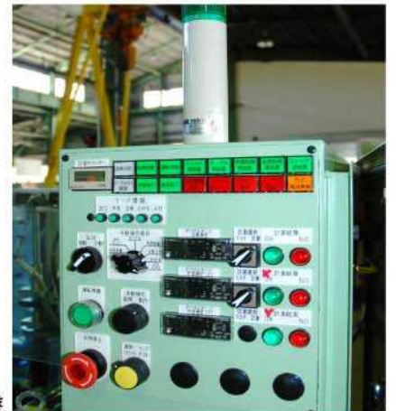
計測装置操作盤
