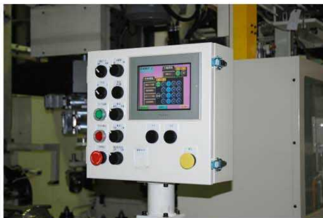
副操作盤—機械前部に配置
