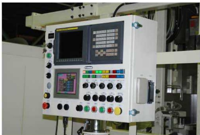
主操作盤—機械左側に配置
