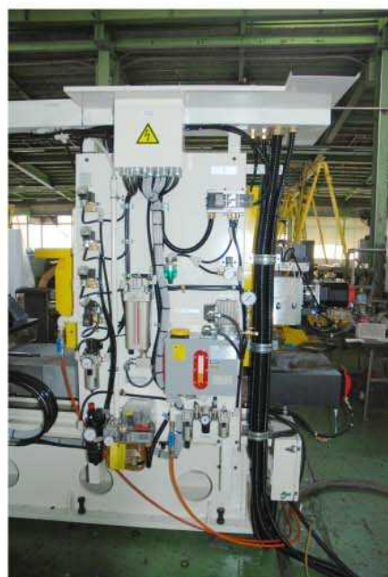
空圧、潤滑ユニット
