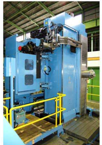
機械コラム側 保守用プラットフォームが コラム側に配置されています
