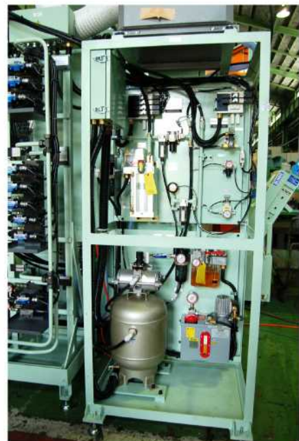
上側より空圧、潤滑、MQL装置
