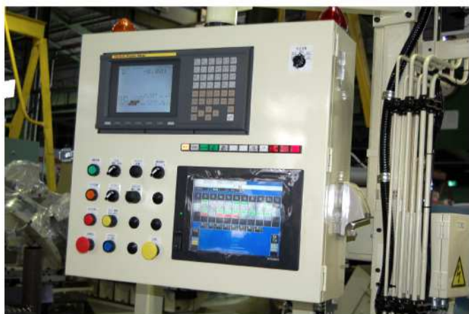
主操作盤、ラインモニター
