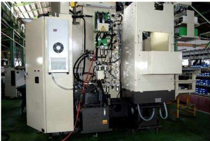
電気制御装置、油圧ユニット
