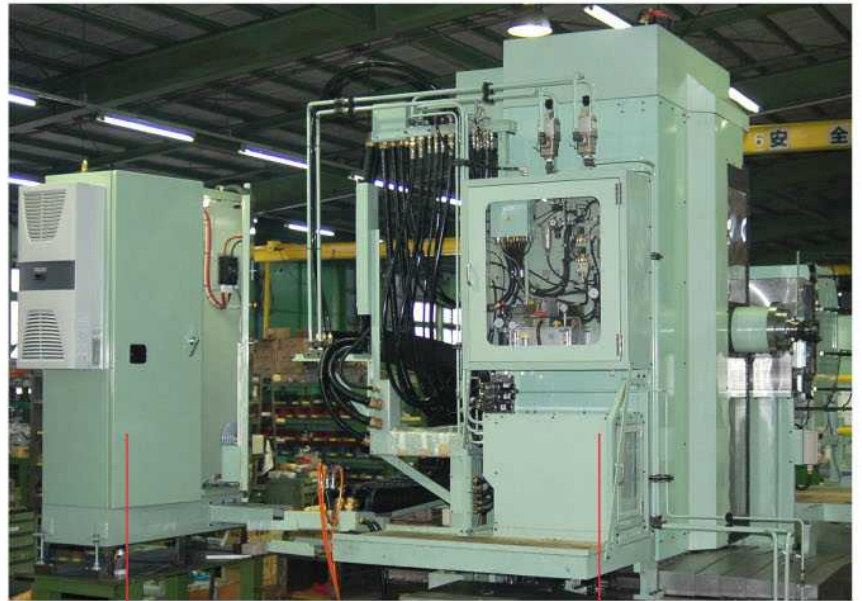
電気制御装置
