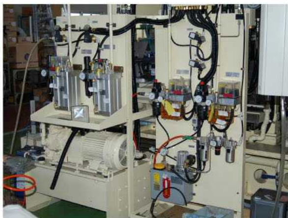
油圧、空圧、潤滑装置
