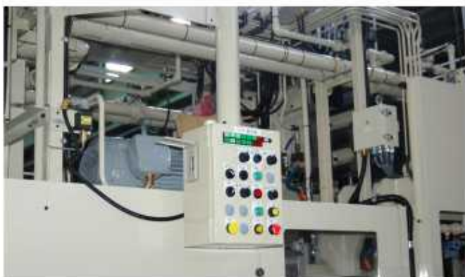
機械左側 副操作盤及びクーラント配管
