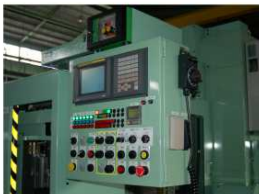
操作盤、上部は補正装置コントロール部
