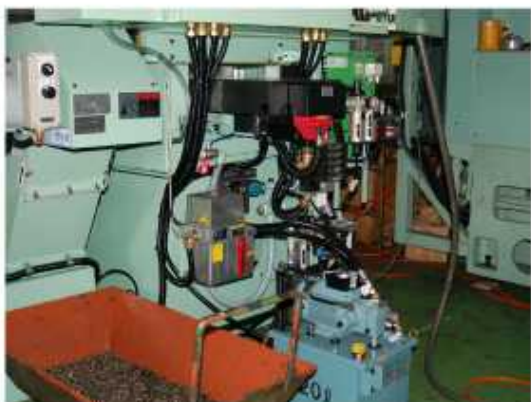
油圧、潤滑、空圧制御部
