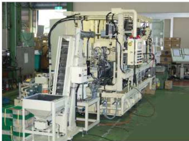
機械全体搬入側
