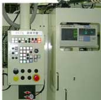
◀4ST/操作盤及び測定装置 コントロール部
