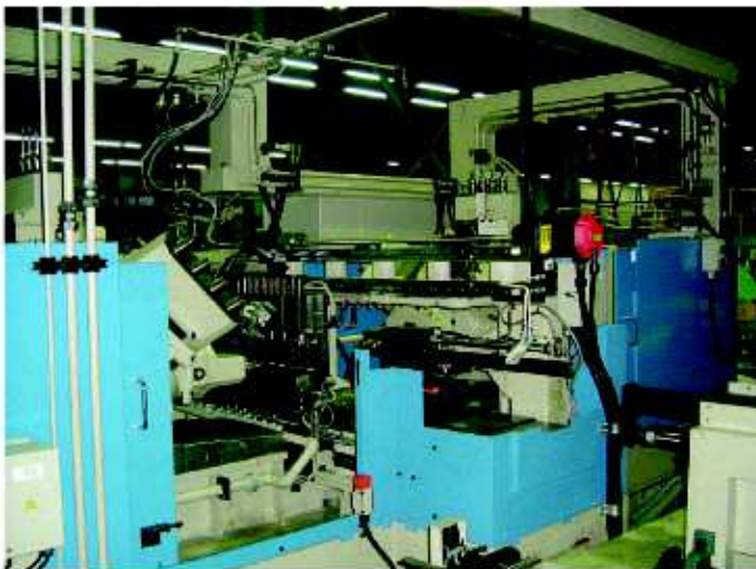
▲レール送り込み位置決め装置（搬出側より）
