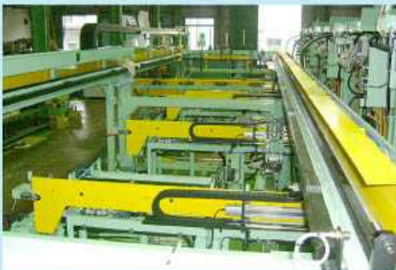
▲ 素材搬入ローダー（上側）及び切断材取り出しローダー（下側）群
